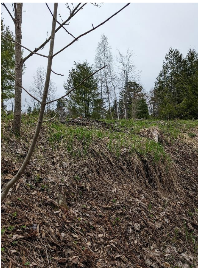
Figure 4 - Rive gauche en aval du barrage (Décrochage du talus aval)
