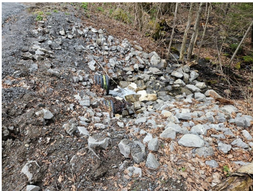
Figure 7 - Conduites d'évacuation en PHED en aval du barrage
